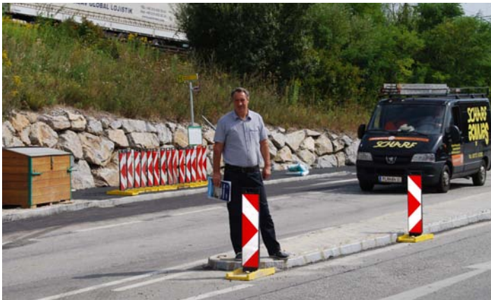
Bürgermeister Josef Schmidl-Haberleitner begutachtet die bereits im Rohbau fertige Schutzinsel vor dem Pressbaumer Kindergarten II
