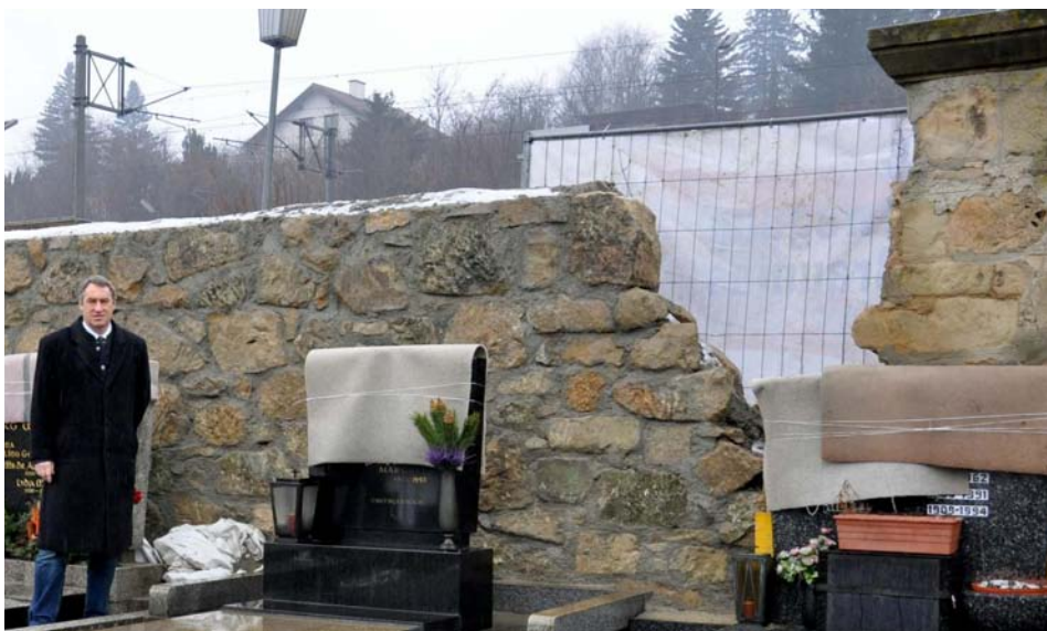
Bgm. Schmidl-Haberleitner besichtigte selbst die beschädigte Mauer am Pressbaumer Friedhof.
