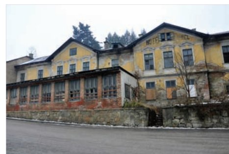
Dieses ehemalige Hotel nächst dem Rekawinkler Bahnhof verfällt zusehends. Das Gebäude ist Einsturzgefährdet. Bürger kritisierten den Zustand der Ruine.
